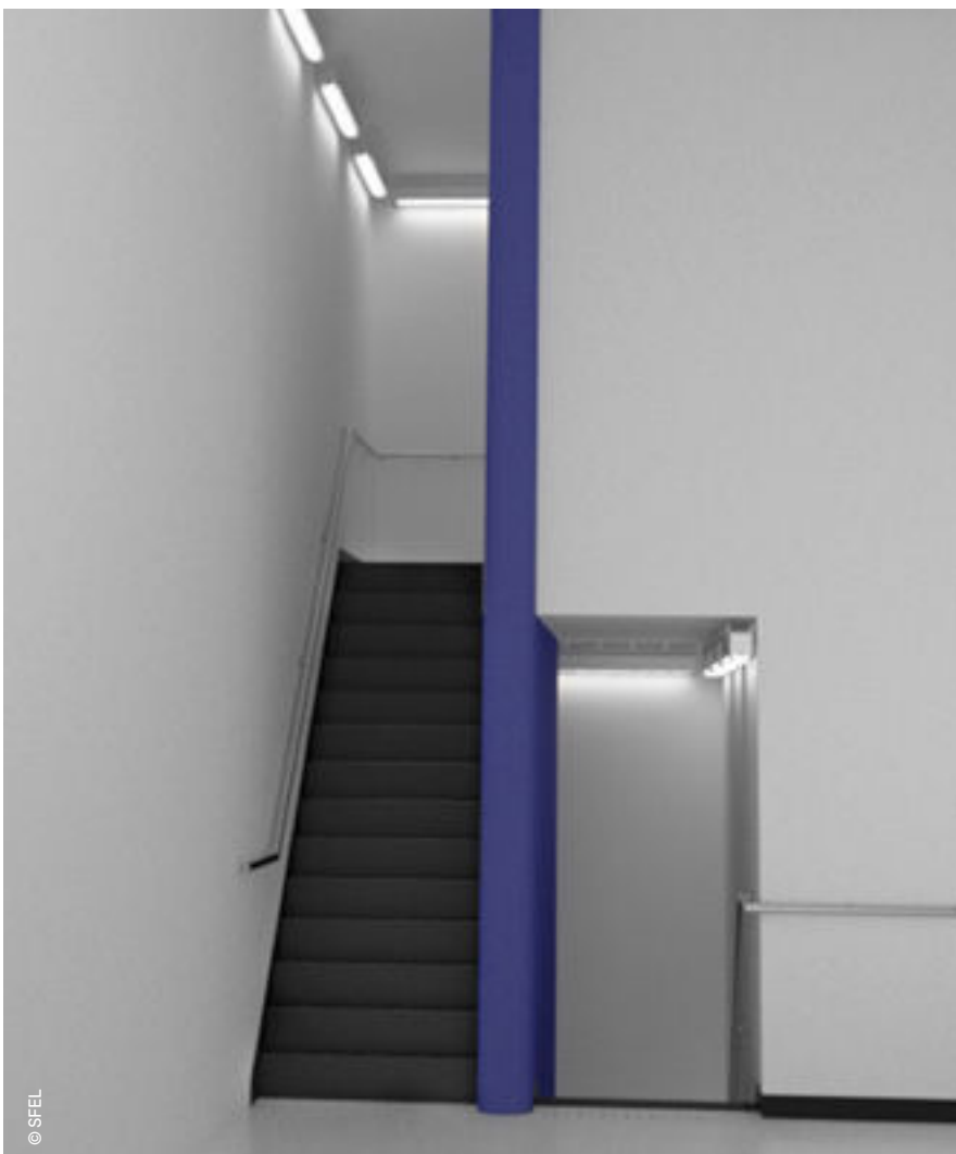
Montage fixe type plafonnier, sur chemin de câble suspendu. Escalier secondaire, de maintenance.
